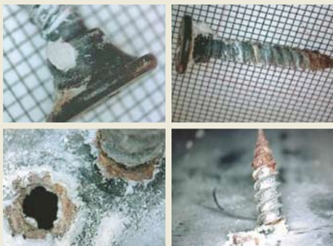
Fehlerquelle Schrauben. Korrosion der phosphatierten Schrauben sowie die Durchdringung der Decken C-Profile.
